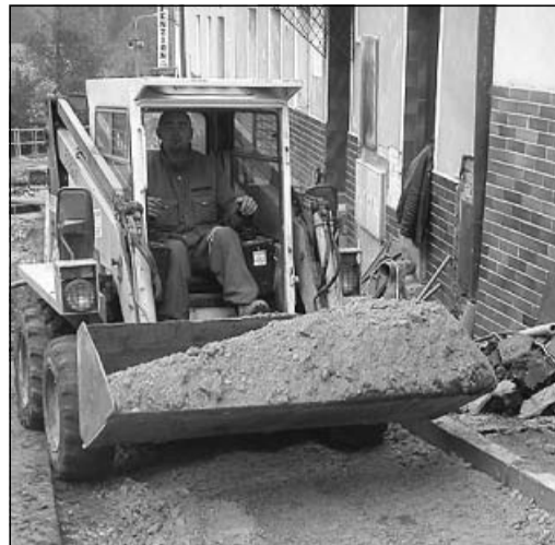
Výměna vodovodu a kanalizace v Rožmberské ulici je hotová. Foto Libor Pils
